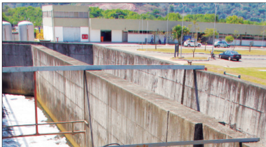
Estação de Tratamento de Esgotos de Sarapuí – Belfor Roxo
