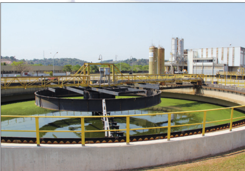
Estação de Tratamento de Esgotos de Sarapuú – Belford Roxo
